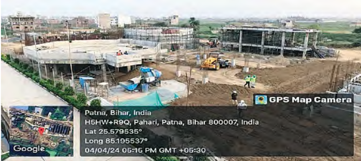
छवि 131 कांकरबाग एसटीपी और सीवरेज 50 एमएलडी नेटवर्क
